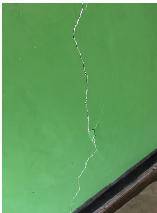
Fissures aux bureaux
