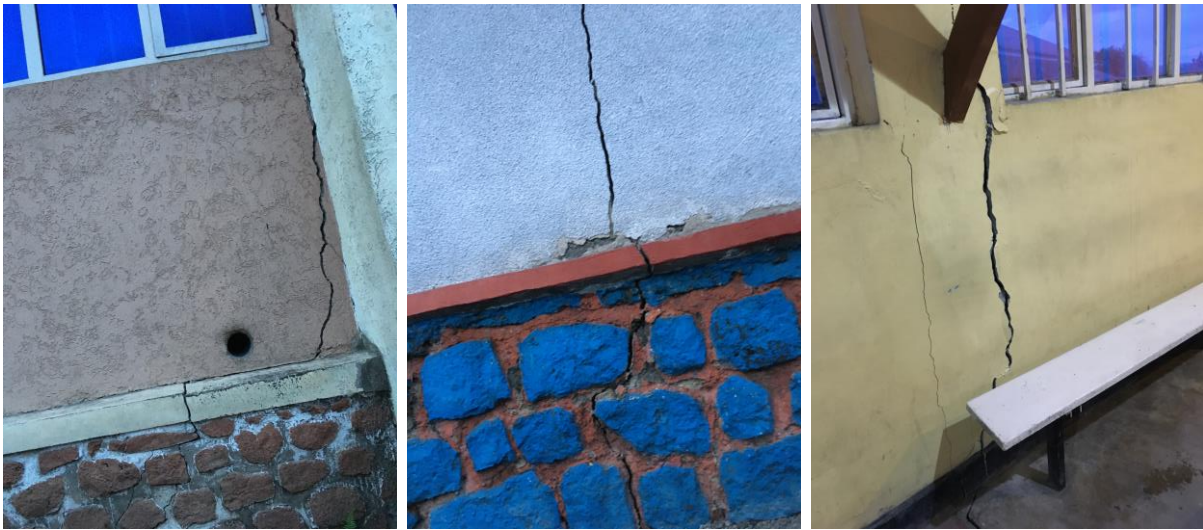
Fissures au centre paroissial des jeunes
